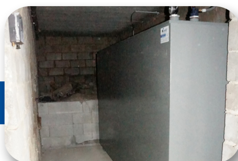
Livraison du réservoir
