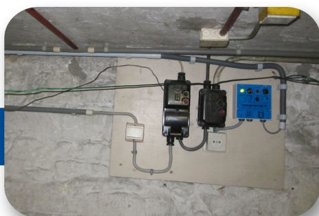
Montage de la détection de fuite de la double paroi
