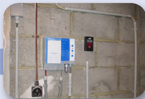
Montage : Jauge électronique, détection de fuite, aspiration mazout
